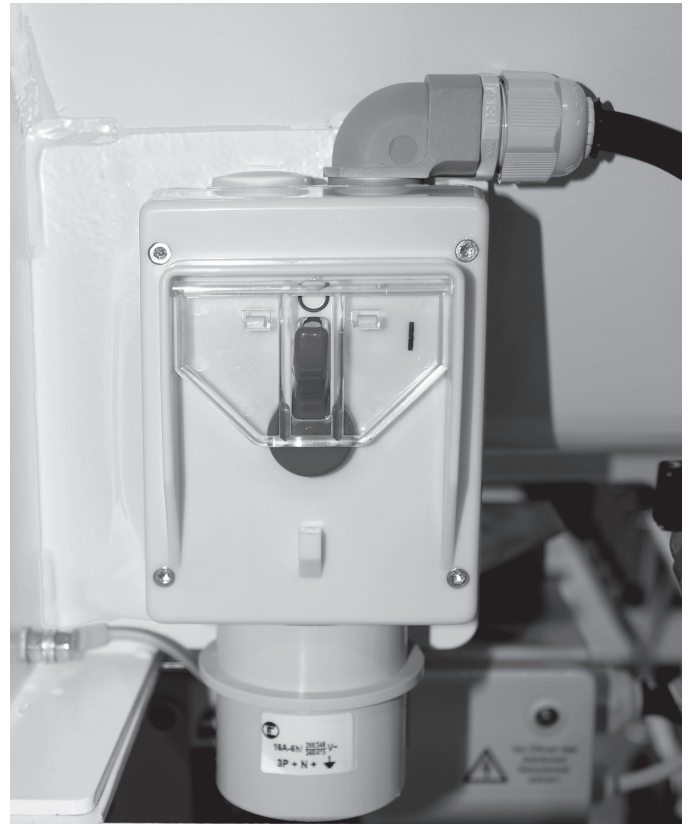
Stromanschluss am Hauptschalter (400 V / 16 A)
