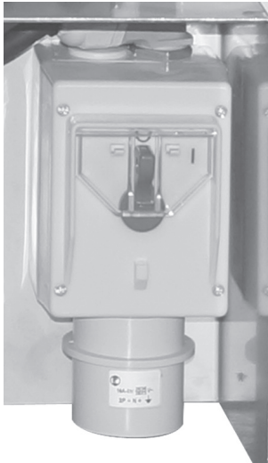
Stromanschluss am Hauptschalter (400 V / 16 A)
