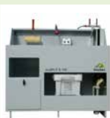
Instalaciones de tratamiento de agua
